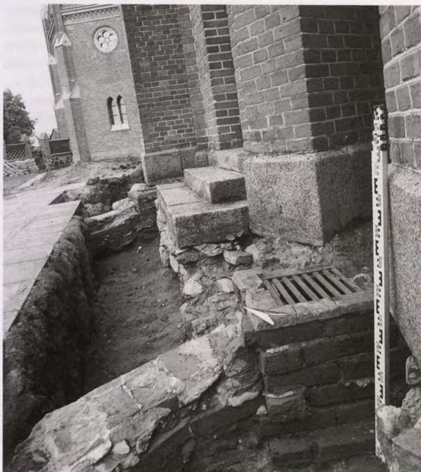
6 pav. Požeminės nuotekų sistemos vandens surinktuvas ir latakai. Nuotr. R. Nabažaitės
